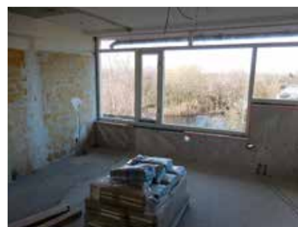
De woon/slaapkamer krijgt een moderne badkamer en ClimaRad verwarming/ventilatie.
